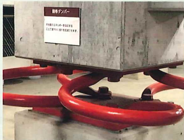
横須賀市役所は免震と耐震の複合型。免震構造の太いダンパー
