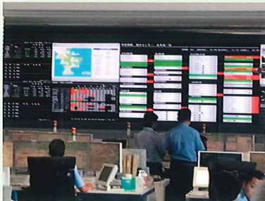
横須賀・三浦・葉山の火災や救急を管理する防災指令センター
