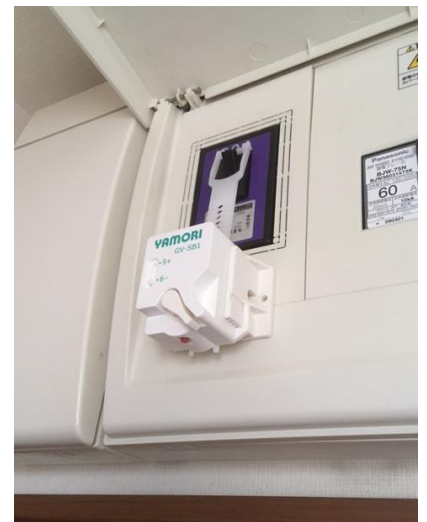
<配電盤に取り付けられた感震ブレーカー>
