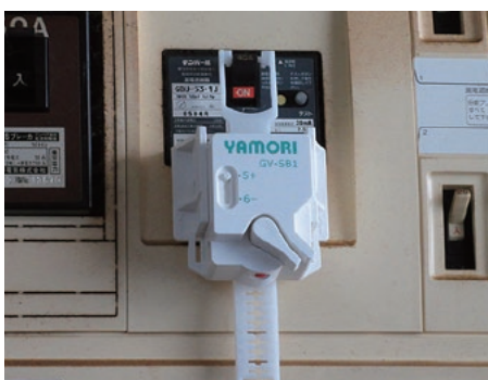
分電盤への取付事例
